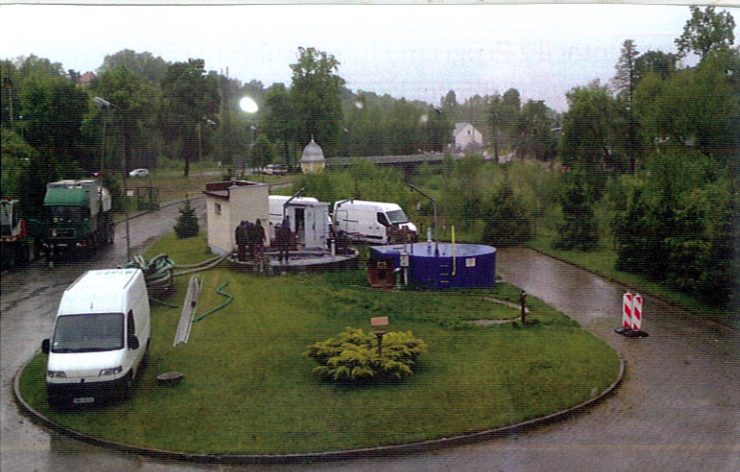
Oczyszczalnia ścieków w Bystrzycy Kłodzkiej
